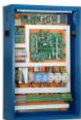
تابلو EC16 هیدرولیک
